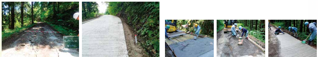
沈み込み→割れ→水の浸透→コンクリート下の土砂流出→コンクリート下隙間→割れ→剥がれ・隆起
